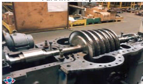
Turbine à vapeur
